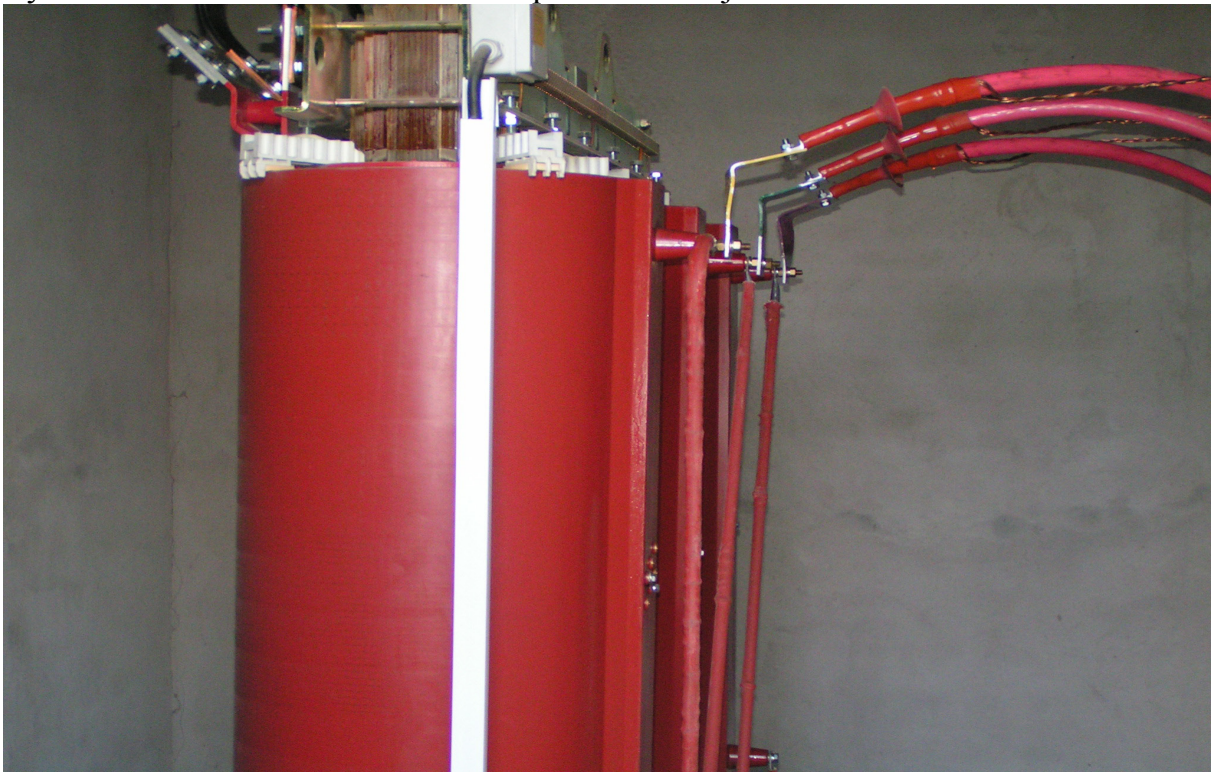
Rys.6. Trafo suche po czyszczeniu
