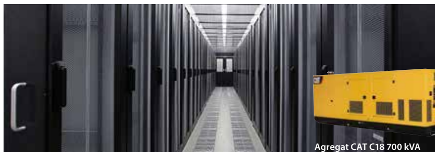
Agregat CAT C18 700 kVA
