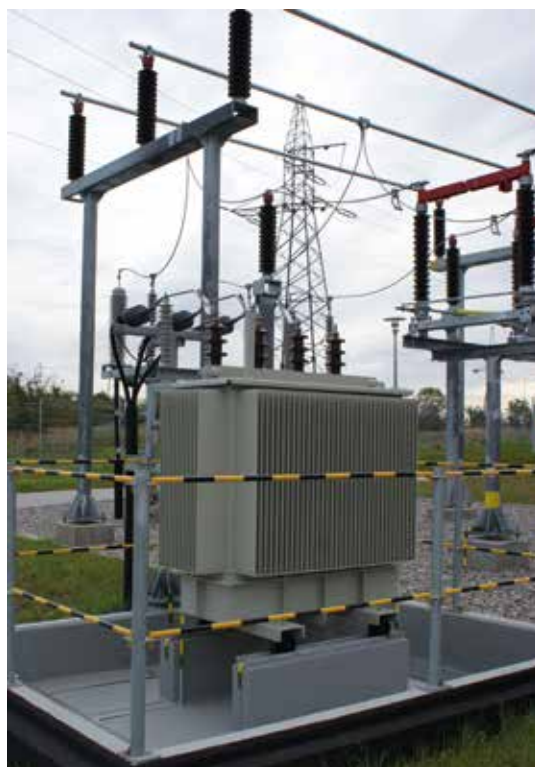
Fot. 1. Widok stanowiska dławik kompensacyjny 30 kV z zabudowaną miłą.
