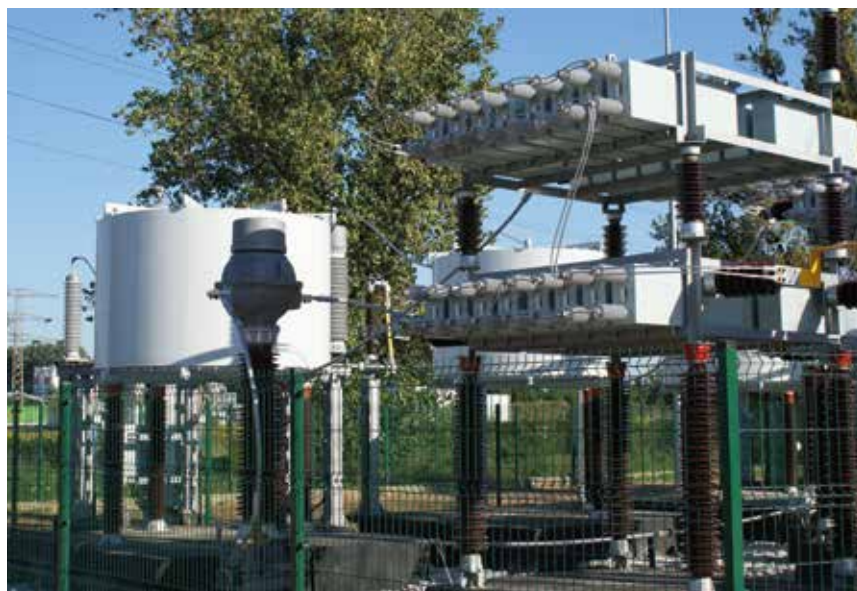
Fot. 4. Widok stanowiska baterii kondensatorów 110 kV prod. OLMEX SA
