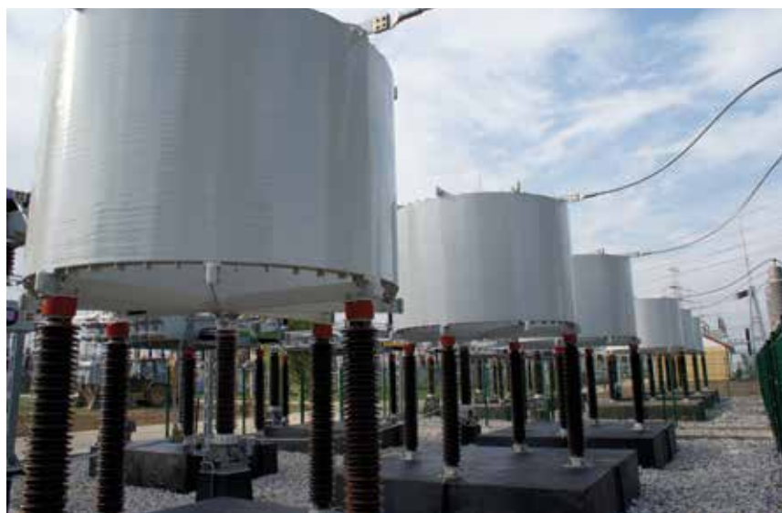
Fot. 2. Widok stanowiska dławików kompensacyjny bezrdzeniowych 110 kV.
