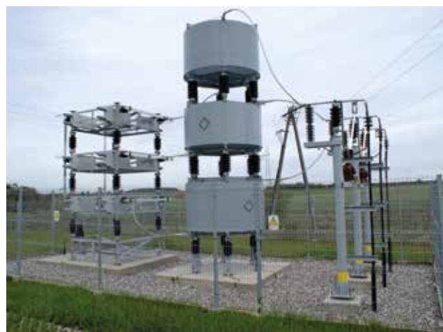
Fot. 3. Widok stanowiska baterii kondensatorów 30 kV typu BKSdn-30 prod. OLMEX SA
